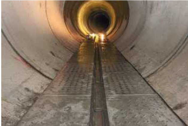
Wärmetauscher in der Kanalisation
