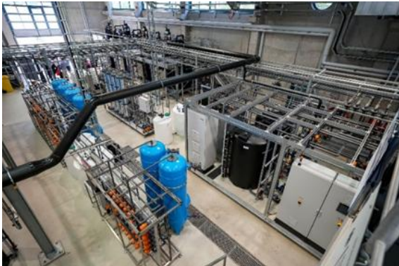
Phosphorrückgewinnungsanlage in Bottrop Foto: EGLV
