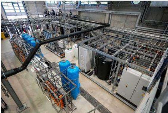
Phosphorrückgewinnungsanlage in Bottrop Foto: EGLV
