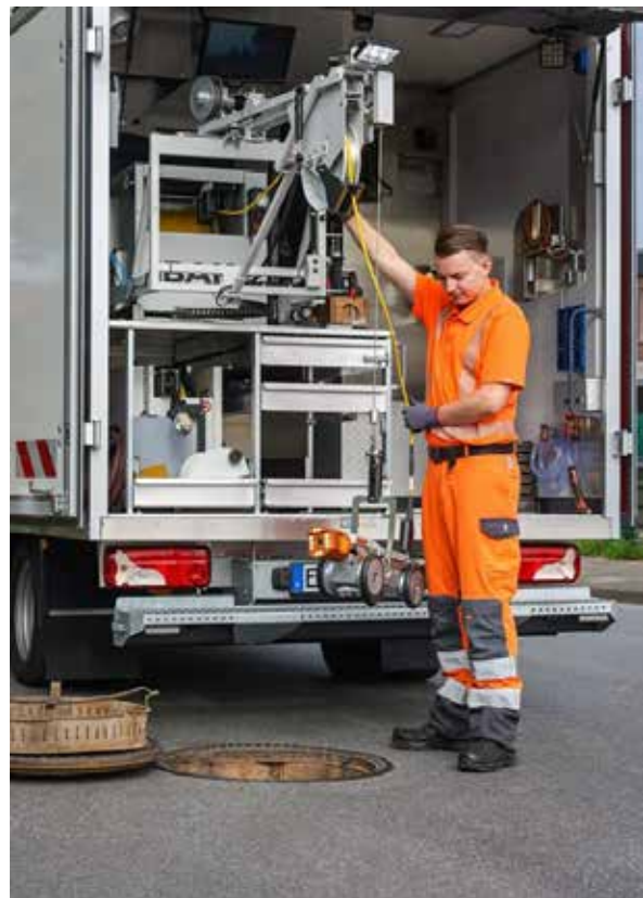
Am TV-Kanalinspektionswagen bereitet ein Auszubildender die nächste Kamerafahrt vor Foto: Rupert Oberhäuser/EGLV
