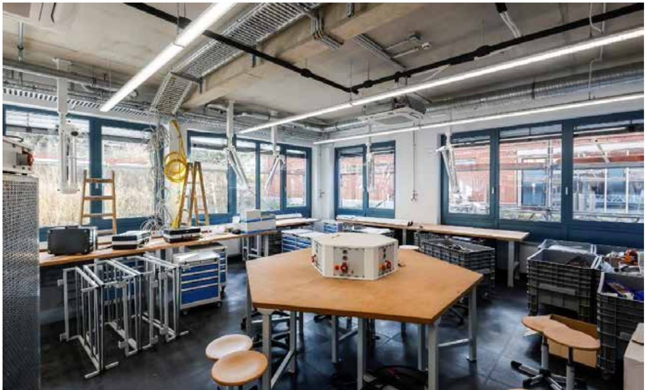
Neubau des Ausbildungszentrums auf dem Gelände der Kläranlage Bottrop Elektrik-Restarbeiten im EG des Zentrums. Stand: 04.11.2020 Foto: Rupert Oberhäuser / EGLV
